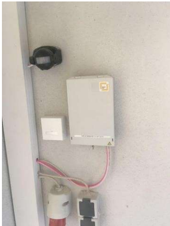
Hausanschlussbox in Garage montiert
